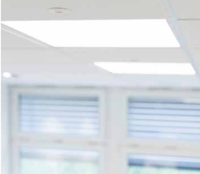
Abb.: Mit Hilfe von vernetzten LED-Panels und Lichtsensoren an der Raumdecke lässt sich die Deckenbeleuchtung präzise auf die allgemeine Tageslichtkurve und den aktuellen Lichteinfall abstimmen. (Quelle: Microsens GmbH & Co. KG)
